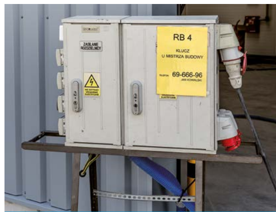
Rozdzielnica zabezpieczona przed dostępem osób nieuprawnionych.
