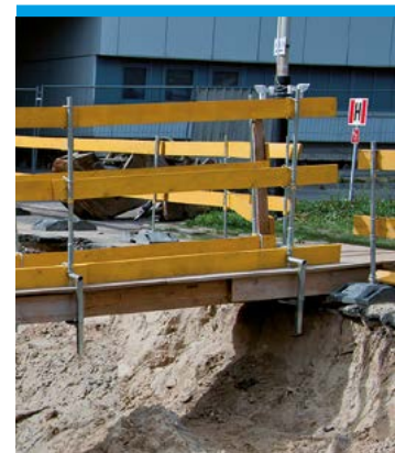
Przejście nad wykopem musi być zabezpieczone balustradami.
